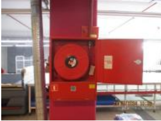
Fire Hose (2).jpg
