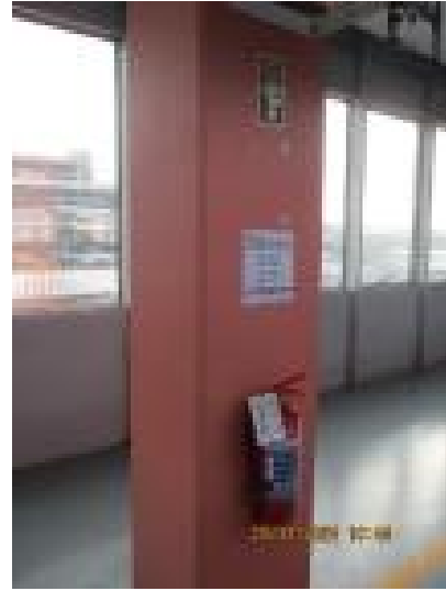
Fire Extinguisher (2).jpg
